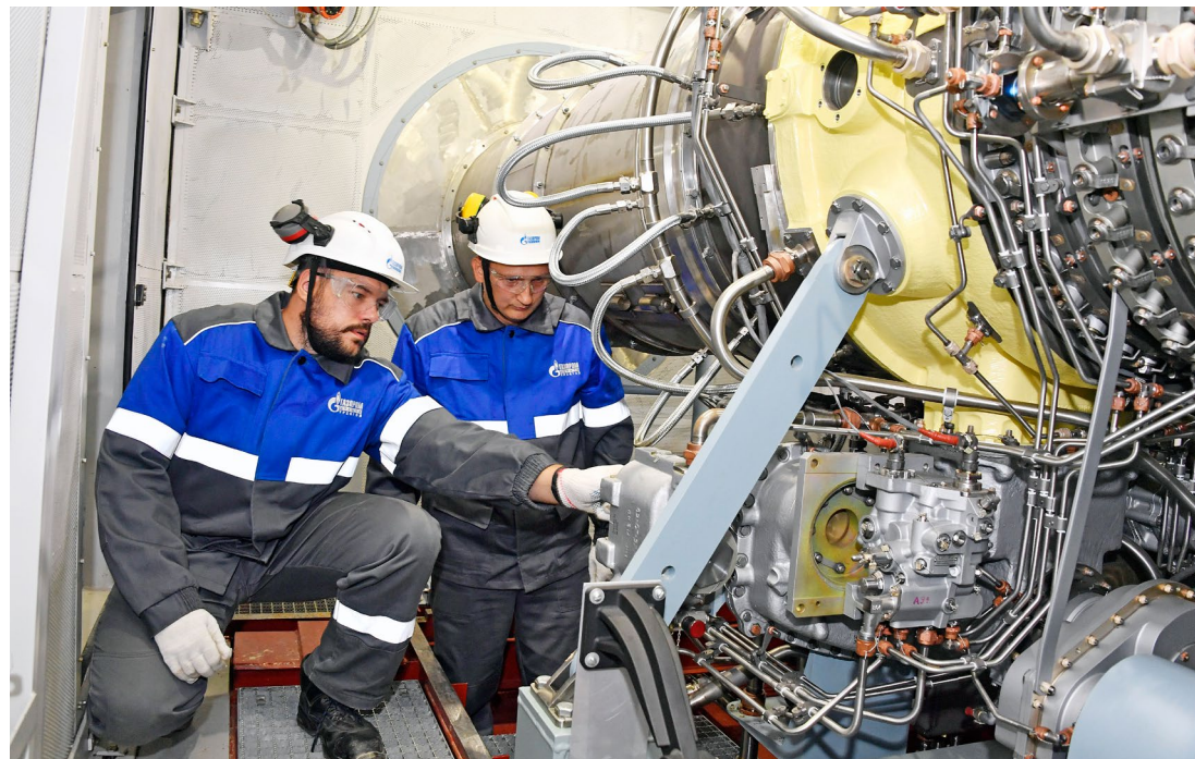
Машинисты технологических компрессоров Олег Карпович и Владимир Коноваленко осматривают газотурбинный двигатель газоперекачивающего агрегата
